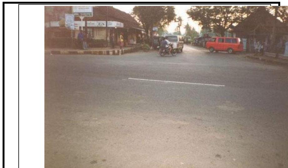
Gambar 11. Foto Kondisi Jalan
