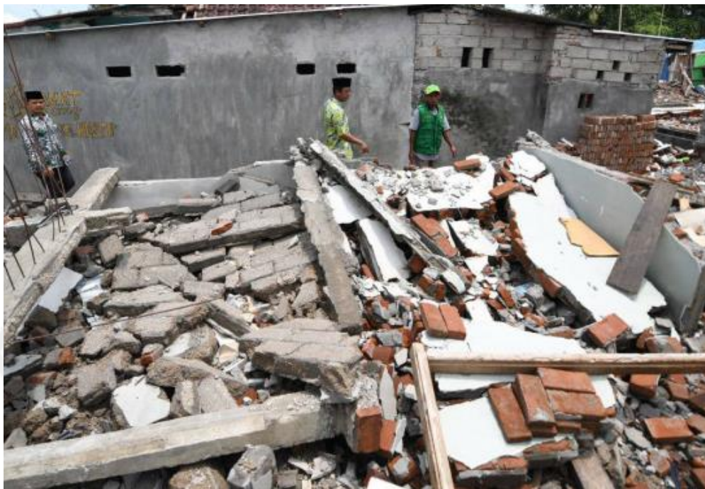
Gambar 1.1 Runtuhan Bangunan Korban Gempa Lombok
